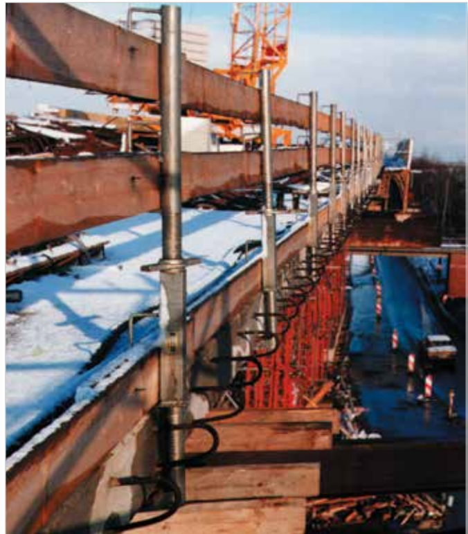
Gebäudekante gesichert mit Geländerhalter TITAN HS
